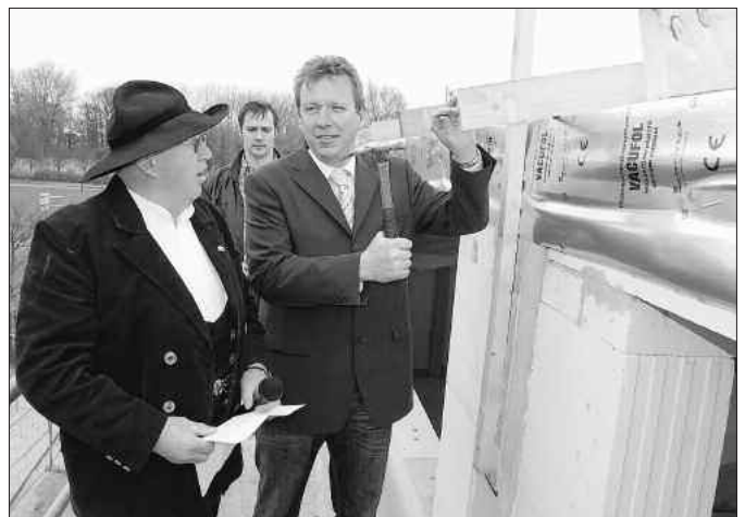
Nach dem Richtspruch von Zimmermeister Heinz Thielke (l.) aus Luckauschlug Landrat Christian Jaschinski (r.) symbolisch den letzten Sparrennagel in die Dachkonstruktion.
